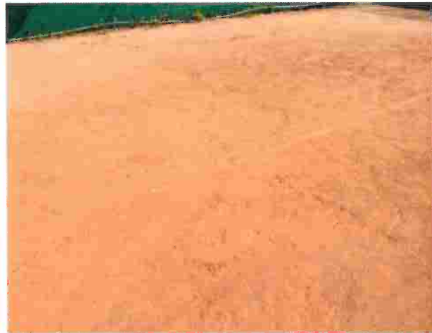
Revêtement de jeu en terre battue fortement détérioré, présentant des défauts de nivellement
