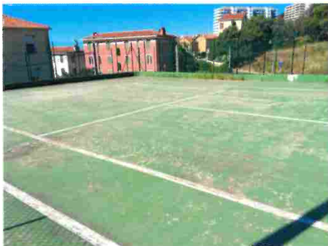
Revêtement du cours en dur fortement détérioré
